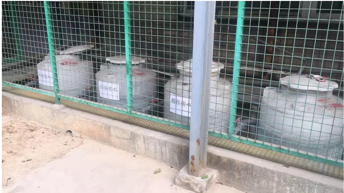
图 7.1-2 废水分类收集罐照片
